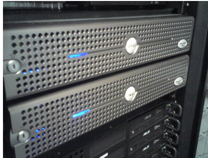
Servidores rack reais. Foto: Dsv/Wikimedia Commons, domínio público.
