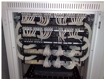
Switches gerenciáveis e patch panels em rack de 19 polegadas. Foto: Dsimic/Wikimedia Commons, CC BY-SA 4.0.
