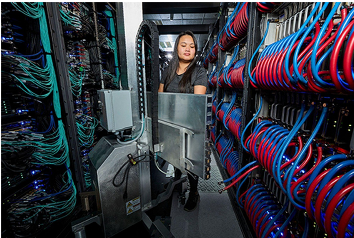
Instalação e manutenção de compute blades do El Capitan. Foto: LLNL.
